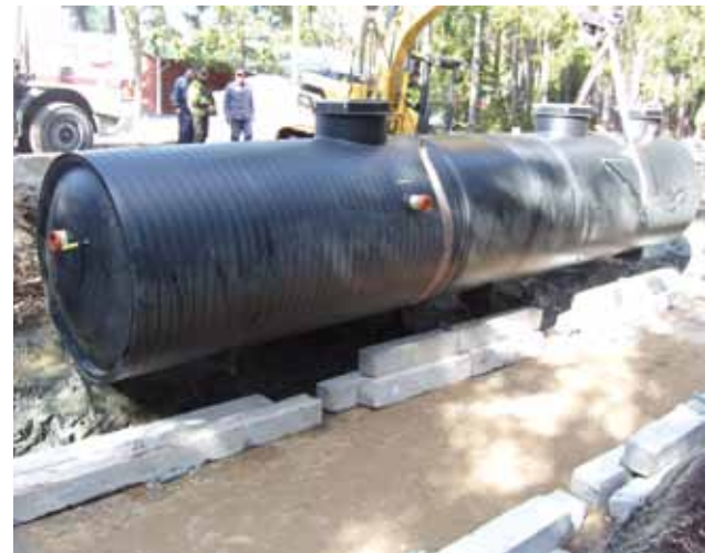
Pienpuhdistamo on massiivinen laitos, joka puhdistaa alueen jätevedet.
