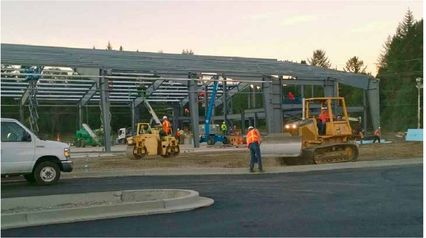
Heissonin rukoushuoneen (church) työmaalla näkyy Lännen yrittäjien tehokas monipuolisuus. Infra näyttää olevan edellä talosta, joka on runkovaiheessa.
