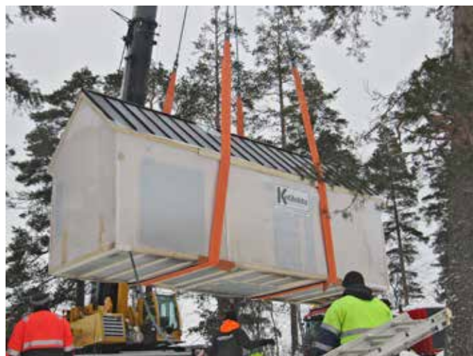
Kuljetuksen ajaksi suojakääreeseen pakattu, Kotilehdon verstaalla valmiiksi rakennettu CLT-mökki nostetaan nosturilla valmiiden perustusten päälle.
