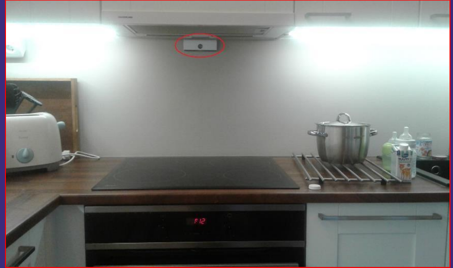
Kuvan sähköhellaan on asennettu liesivahti.
