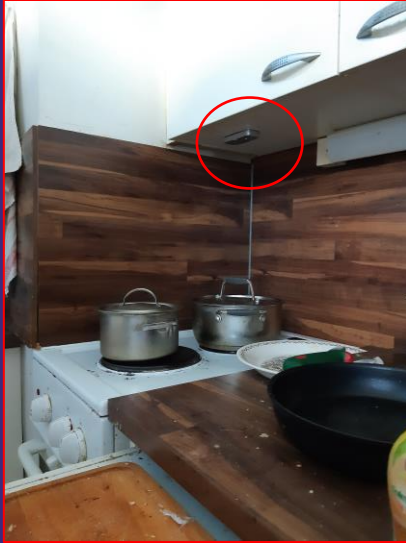
Kuvan sähköhellaan on asennettu liesivahti.
