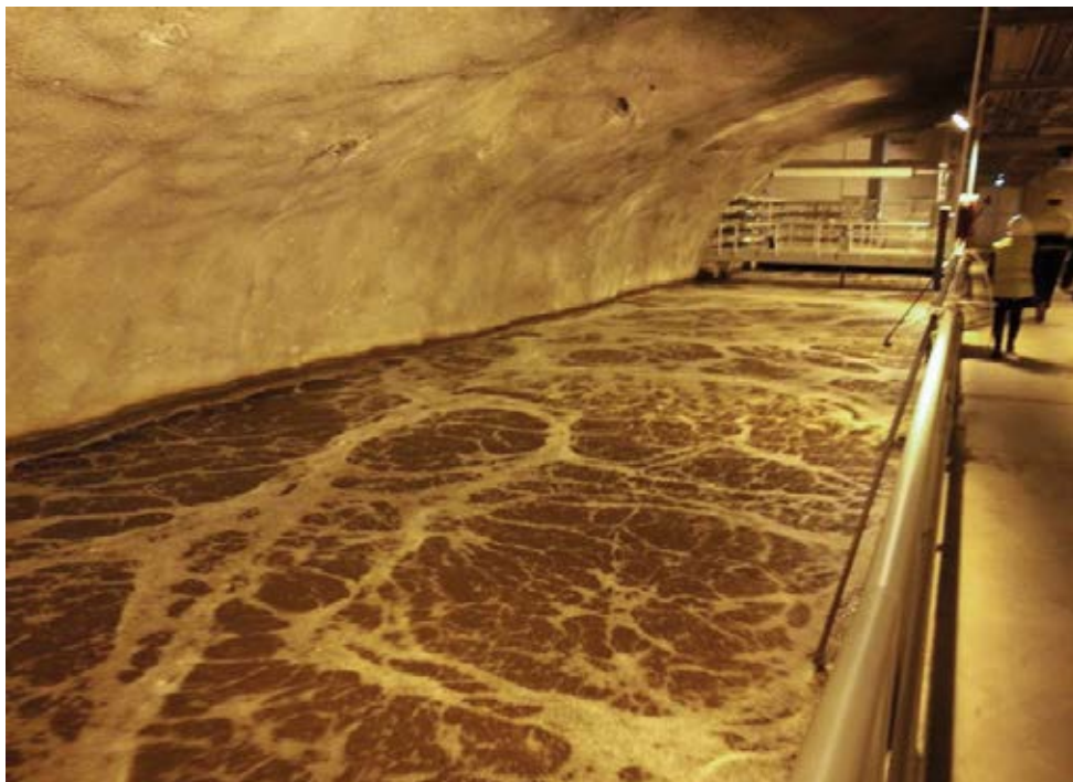
Tässä altaassa vesi puhdistuu mm. bakteeritoiminnan avulla.
