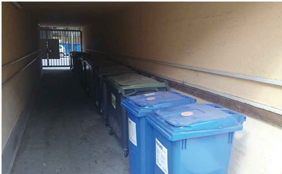
Porttikäytävä ei ole oikea paikka jäteastioille!
