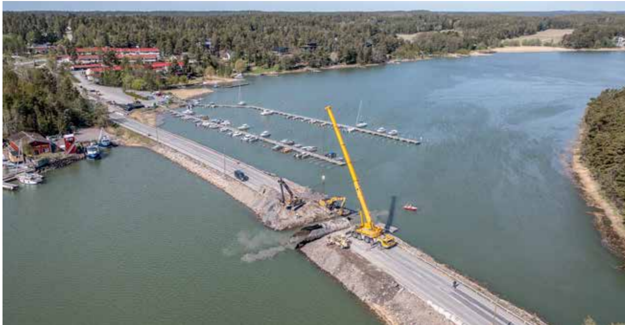
Särkänsalmen pengertien siltarumpu uusittiin vuonna 2022 kevyen liikenteen väylän rakentamisen yhteydessä. Kuva: Veijo Lindgren
