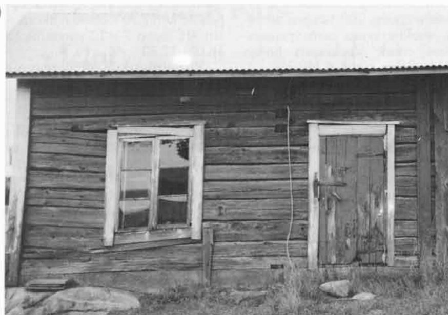
Uudenkartanon saunarakennus, jossa vieraat asustelivat yli 50 vuotta sitten. Varoituskylttiä eikä piikkilankoja ei enää näy, mutta aika on tehnyt tehtävänsä. Katoavaa historiaa tämäkin.
