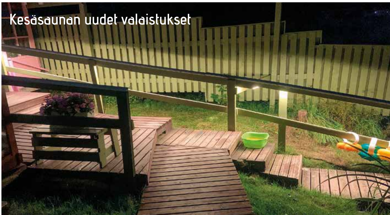
Hietasaaren suosittu kesäsauna sai uudet tunnelmavalot ympäri saunaa. Kuvassa järveen johtavaan porraskaitteeseen asennetut led-valot.
