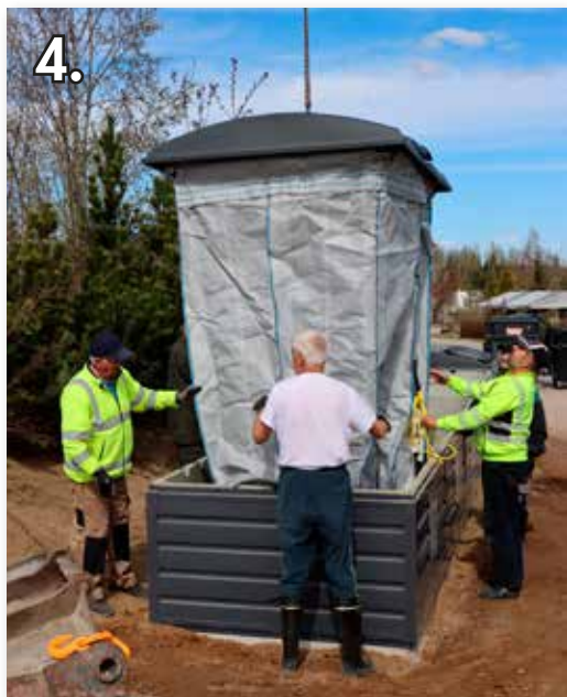
4. Ensimmäinen jätessäkki laskeutuu jätelaatikkoonsa. Jätteen tyhjennys toimii samoin. Nosturi nostaa säkin ja tyhjentää sen jäteautoon, jonka jälkeen säkki palautetaan paikoilleen.
