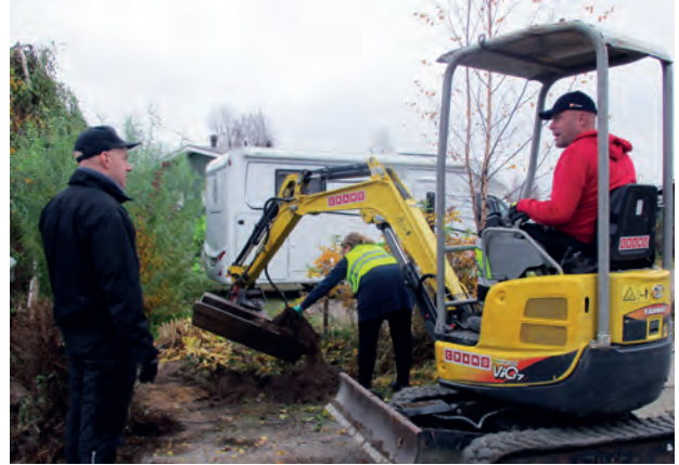
Kaivurilla huono pensas pois ja tilalle uusi.
