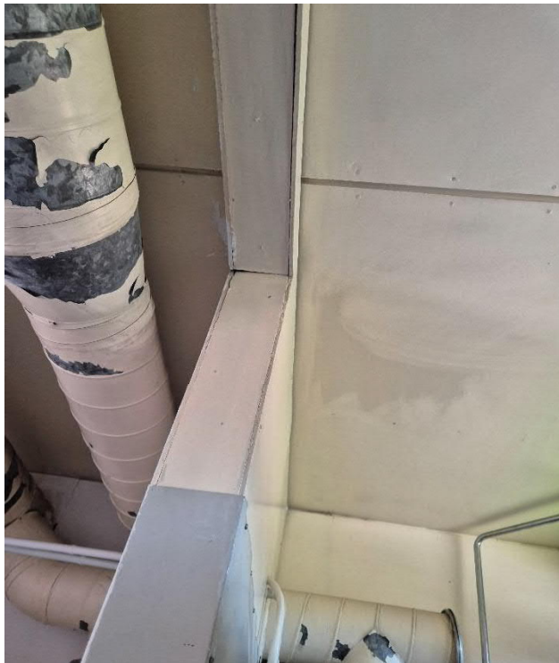
Kuva 3. Asbestipitoiset sementtilevyt ovat kiinnitetty nautoilla.
