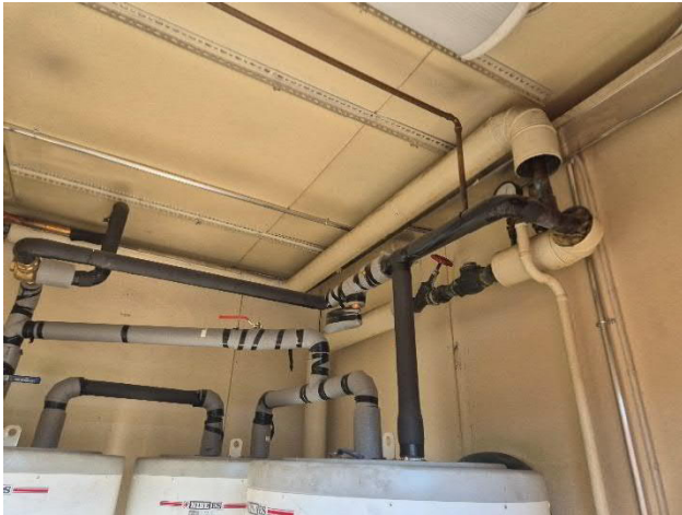
Kuva 13. Lämmönjakohuoneessa havaittiin uusittuja putkieristeitä. Vaahtomuovi tyypillisesti sisältää f-kaasuja, mikä tulee ottaa huomioon jätteenkäsittelyssä.
