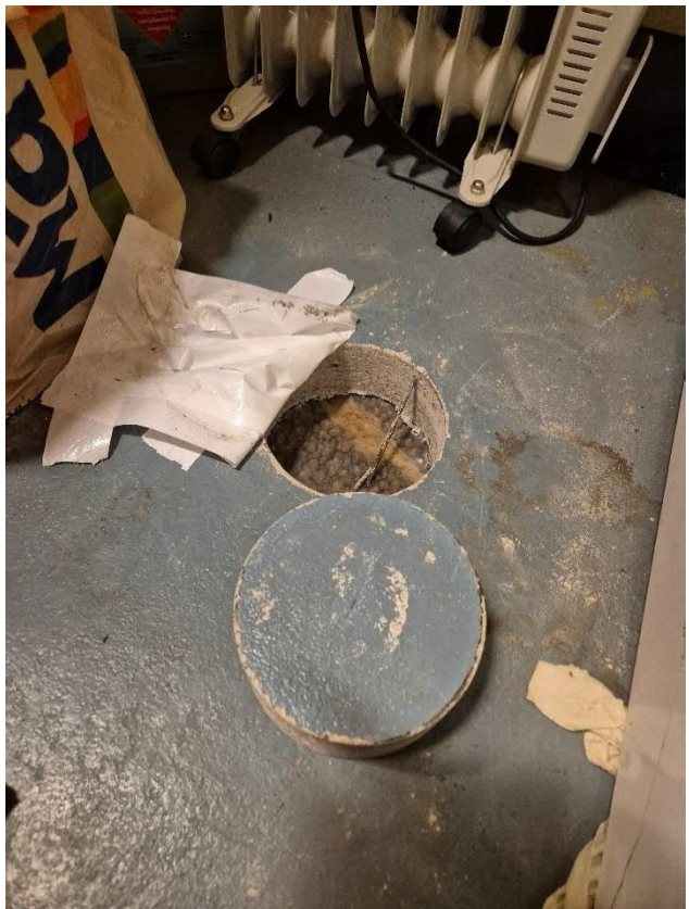
Kuva 16. Varaston betonilaatan alla ei havaittu vedeneristettä.
