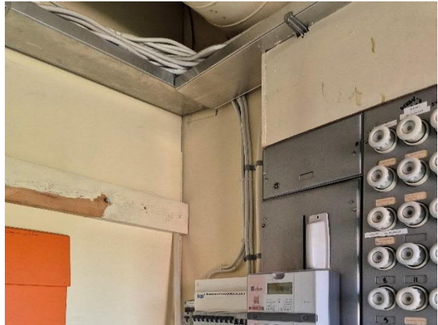
Kuva 14. Sähköpääkeskuksen koteloinnit ovat asbestipitoista sementtilevyä.
