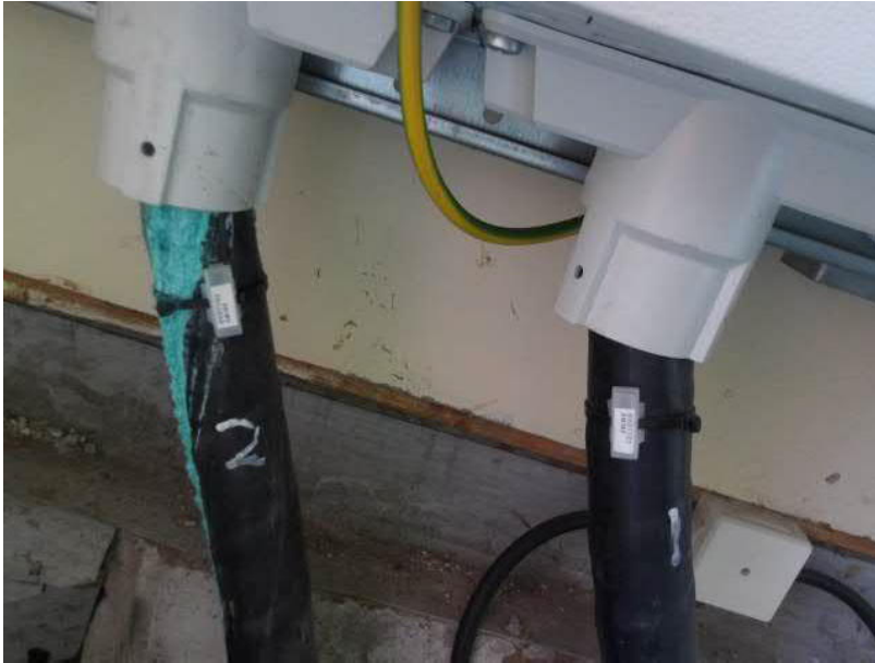
Kuva 51. Yleiskuva uusituista sähköliitoskaapeleista. Toisessa on hapettumaa.
