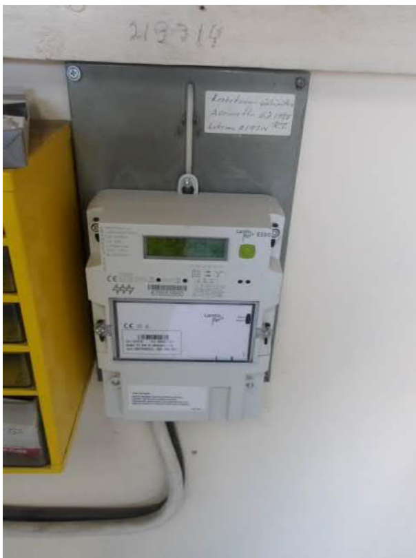
Kuva 47. Yleiskuva kerhotilan kWh-mittarista.
