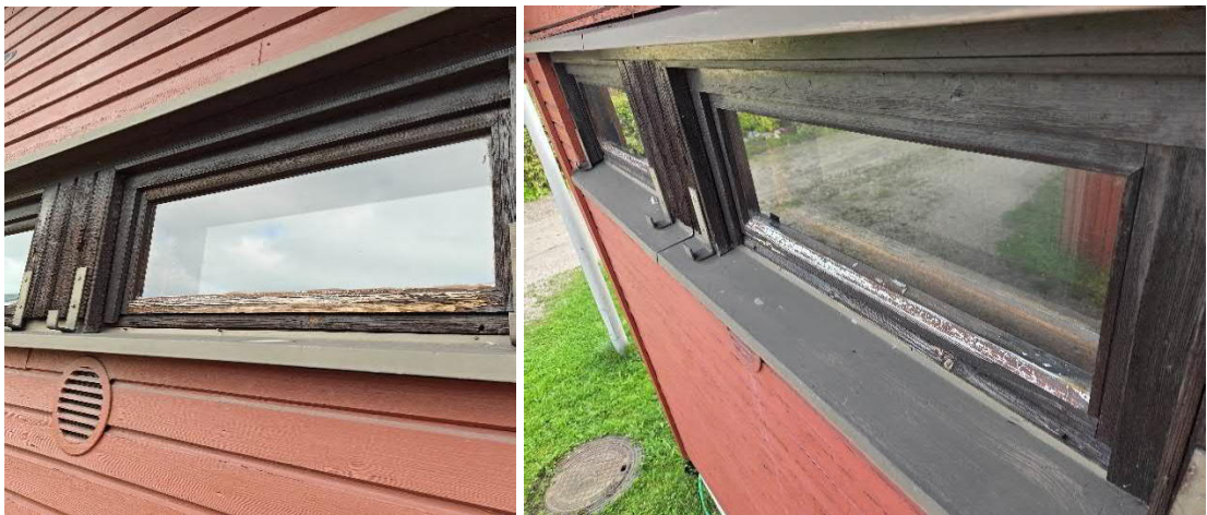
Kuva 21 ja Kuva 22. Länsipäädyn ikkunoiden puuosissa on havaittavissa vaurioita ja kulumaa.
