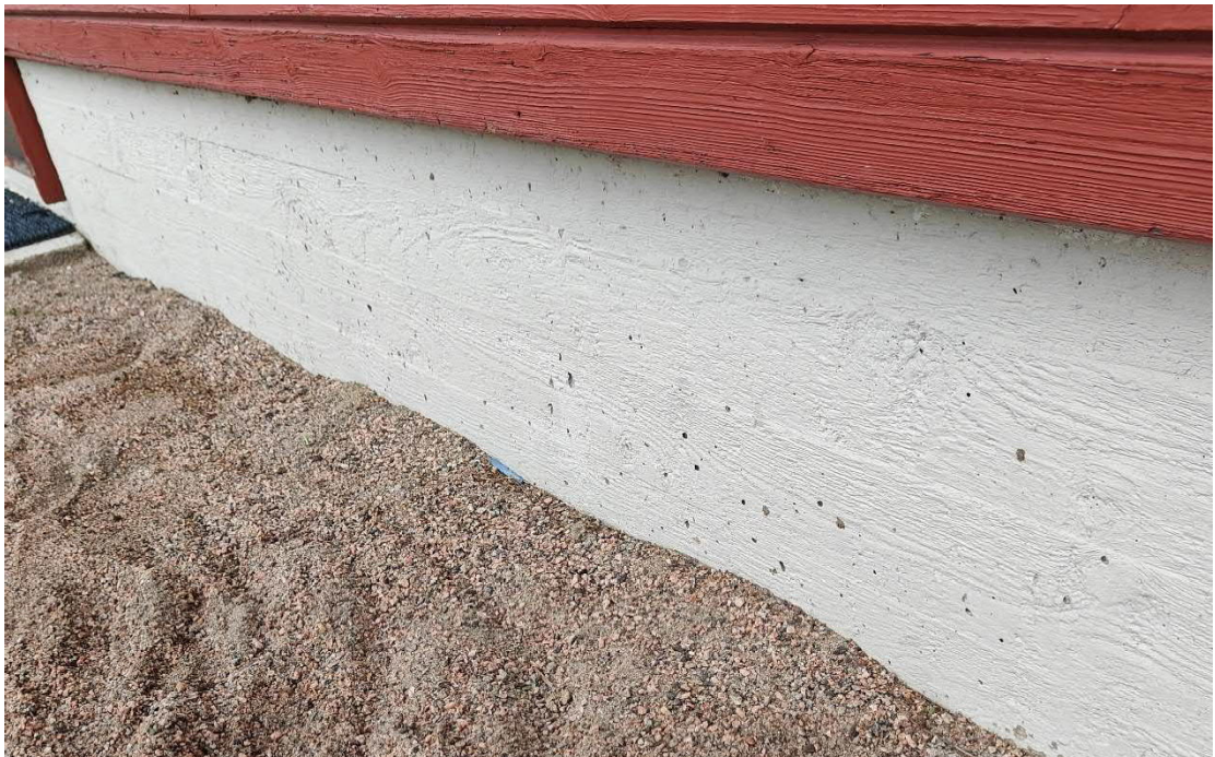
Kuva 9. Sokkelit ovat pääsääntöiset hyvässä kunnossa, eikä isompia vaurioita havaittu. Patolevy puuttuu.
