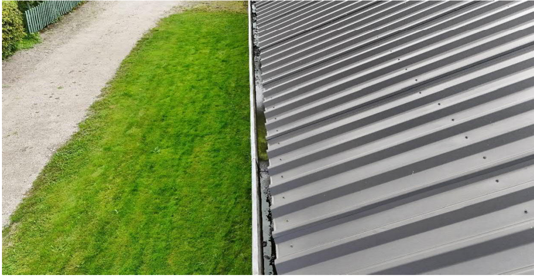
Kuva 3. Ränneissä on paikoin roskaa.
