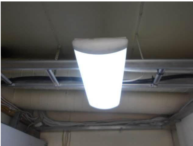
Kuva 56. Yleiskuva teknisen tilan valaisimesta.
