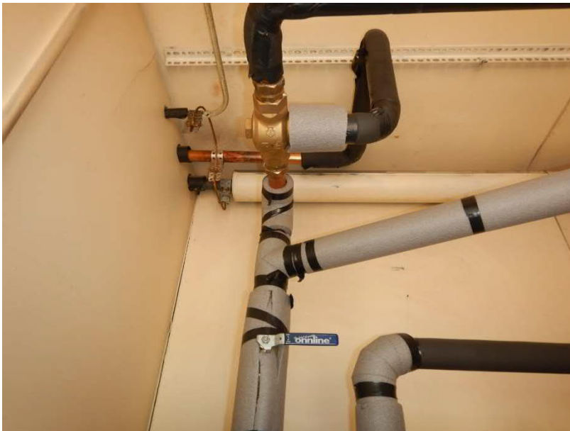
Kuva 34. Yleiskuva säätöventtiilistä ja käyttövesiputkiasennuksista.
