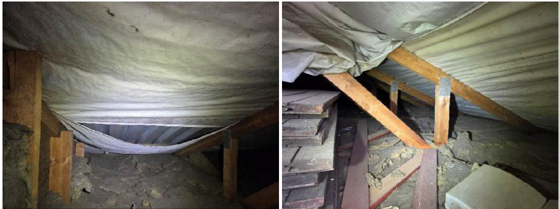
Kuva 28 (vasen). Yläpohjassatilassa havaittiin repsottavia aluskatteita ja painuneita eristevilloja. Lämmöneristevillat ovat paksun pölyn ja lian peitossa.
