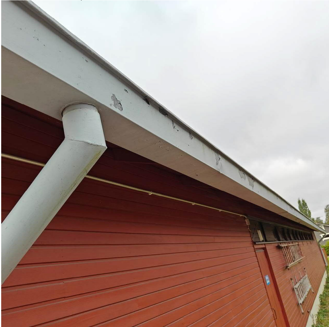
Kuva 4. Räystääkourujen maalipinta hilseilee ja osittain vuotaa.
