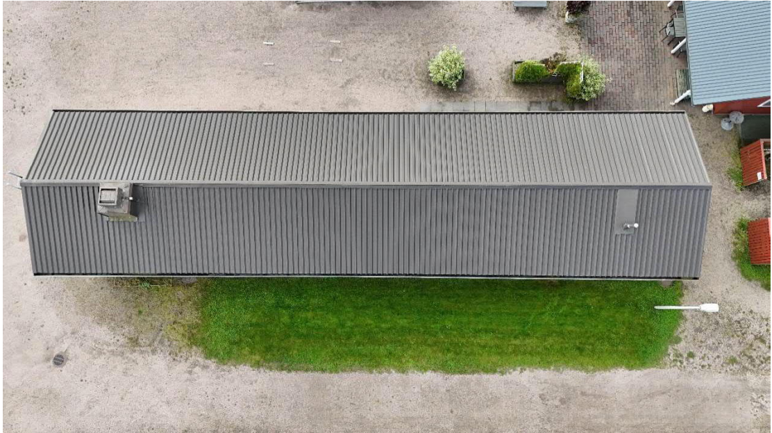
Kuva 25. Yleiskuva vesikatosta. Katolla ei ole kattoturvatuotteita.
