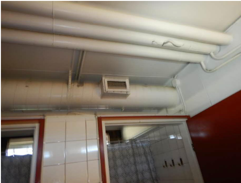
Kuva 41. Osa poistoilmasäleiköistä on likaisia.
