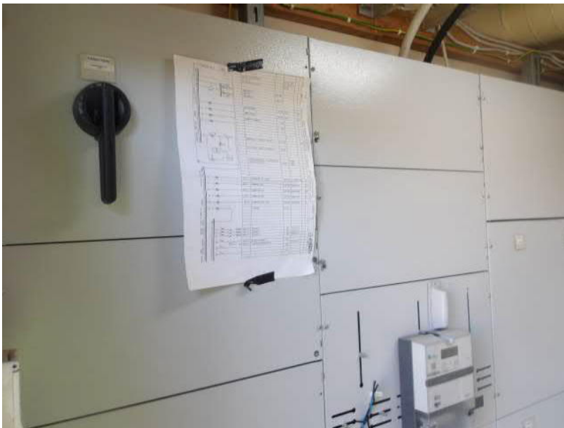
Kuva 48. Yleiskuva uusitusta pääkeskuksesta.
