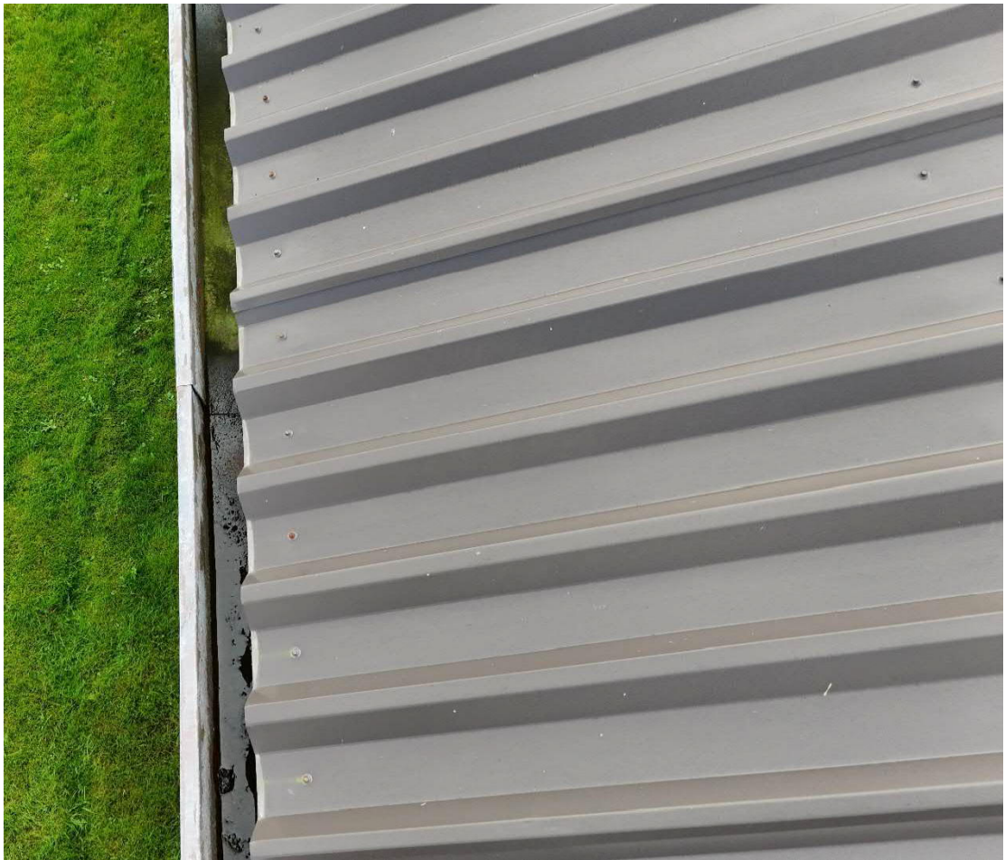
Kuva 26. Vesikatteen maalipinta on ok kunnossa. Rännikourujen läheisyydessä olevat kateruuvit ovat paikoin ruosteessa.
