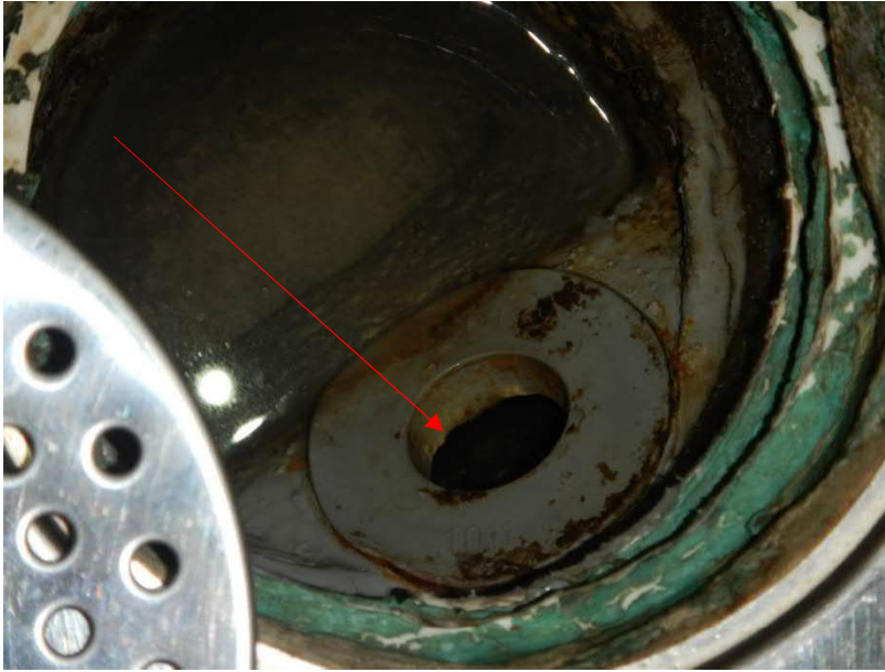
Kuva 35. Lattiakaivoissa vaikuttaa olevan osittain jonkinlainen ruiskupinnoitus. Rassireiän tulppa puuttuu.
