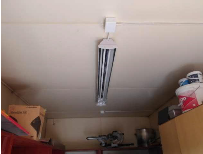
Kuva 57. Yleiskuva varastotilan valaisimesta.
