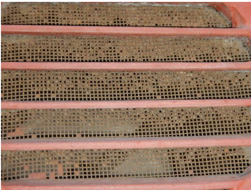
Kuva 42. Osa korvausilmasäleikköjen hyönteisverkoista on lähes tukossa.
