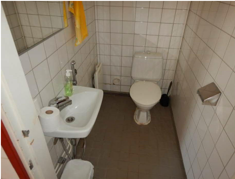
Kuva 37. Yleiskuva vesi- ja viemärikalusteista.
