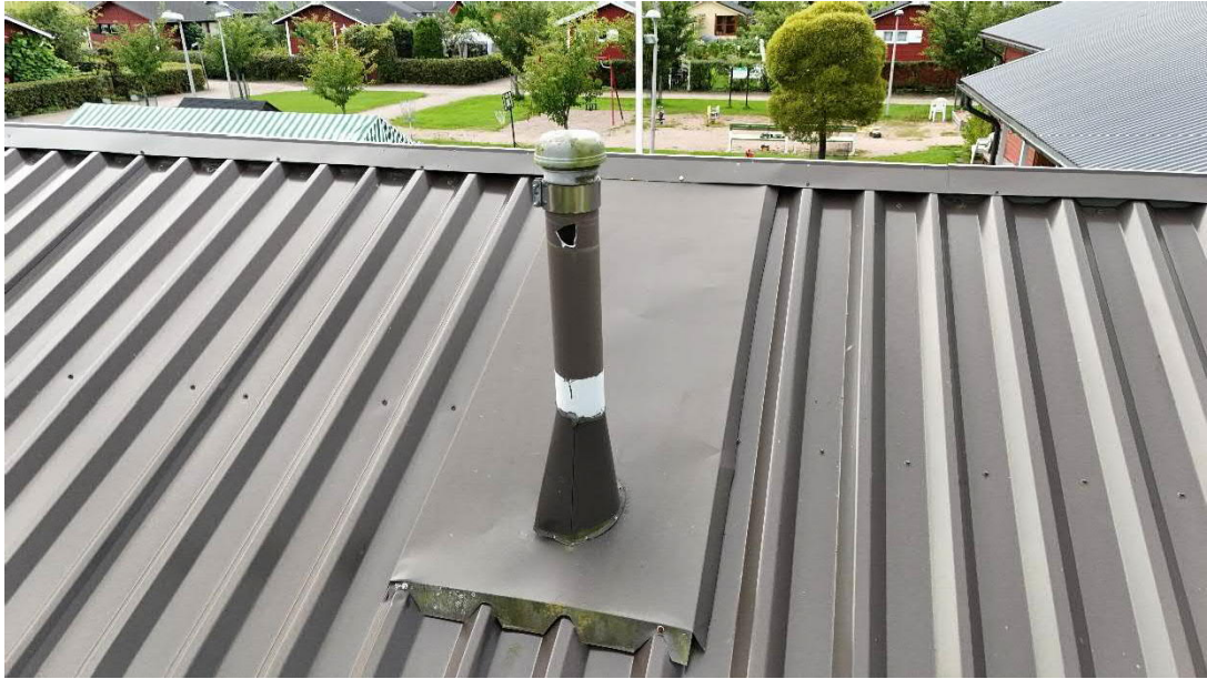
Kuva 27. Viemärin tuuletusputkessa on reikä.
