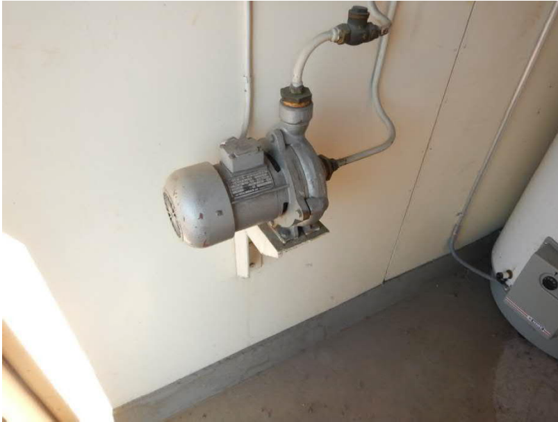
Kuva 33. LV-kiertovesipumppu on alkuperäinen ja se ei ollut päällä (sulut olivat myös kiinni).
