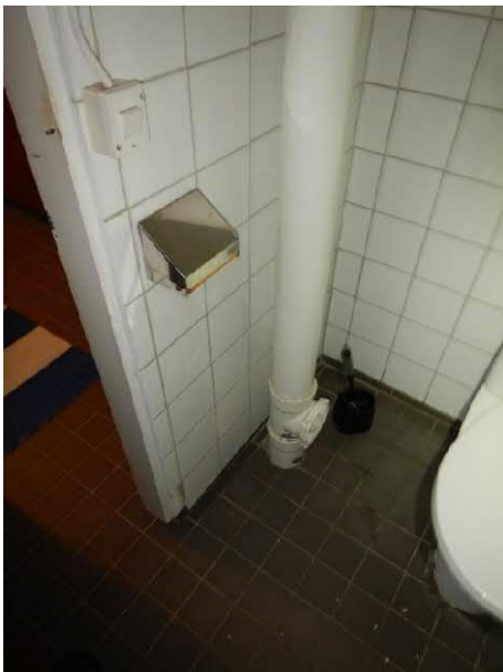
Kuva 38. Viemärit ovat näkyvin osin muhvollisia muoviviemäreitä.
