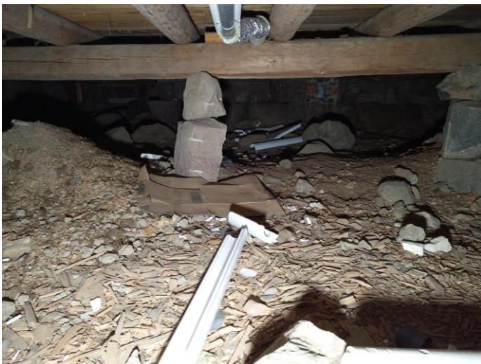
ALAPOHJAA, huomioi irronnut putkieriste
