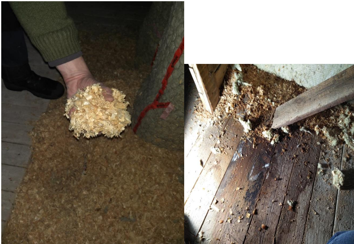
PURUERISTE JA VAURIOKOHTA, päärakennus
