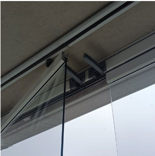
Parvekelasi ei pääse aukeamaan kunnolla.
