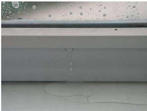
Kuva 3. Vesivuoto ulkopuitteen lasituslistan alta.
