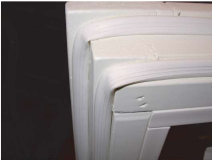
Kuva 1. Sisäpuutteen tiivisteiden venyttäminen asennuksen yhteydessä tekee epätiiviyyskohdat puitteen nurkkiin.
