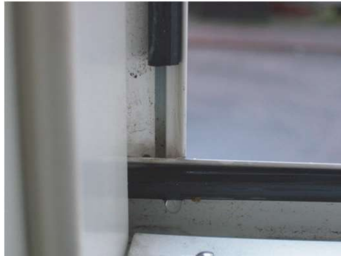
Kuva 2. Ulkopuitteen tiivisteiden kutistuminen teki raon ikkunan alnurkkiin.
