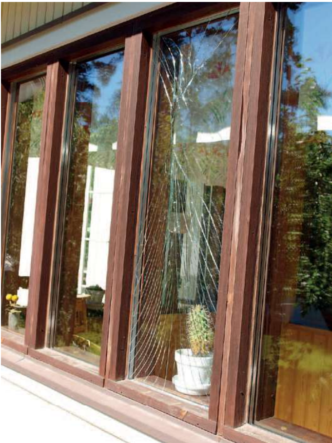
Kuvat 7 ja 8. Taivutuksen aiheuttamia lasirikkoja.
