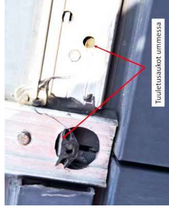
Kuva 2. Laseinän puutteellinen tuuletus. Aukot tukossa! puuttuvat. Kouru kallistaa sisäänpäin. Sekarakenne lasi/kasetti.
