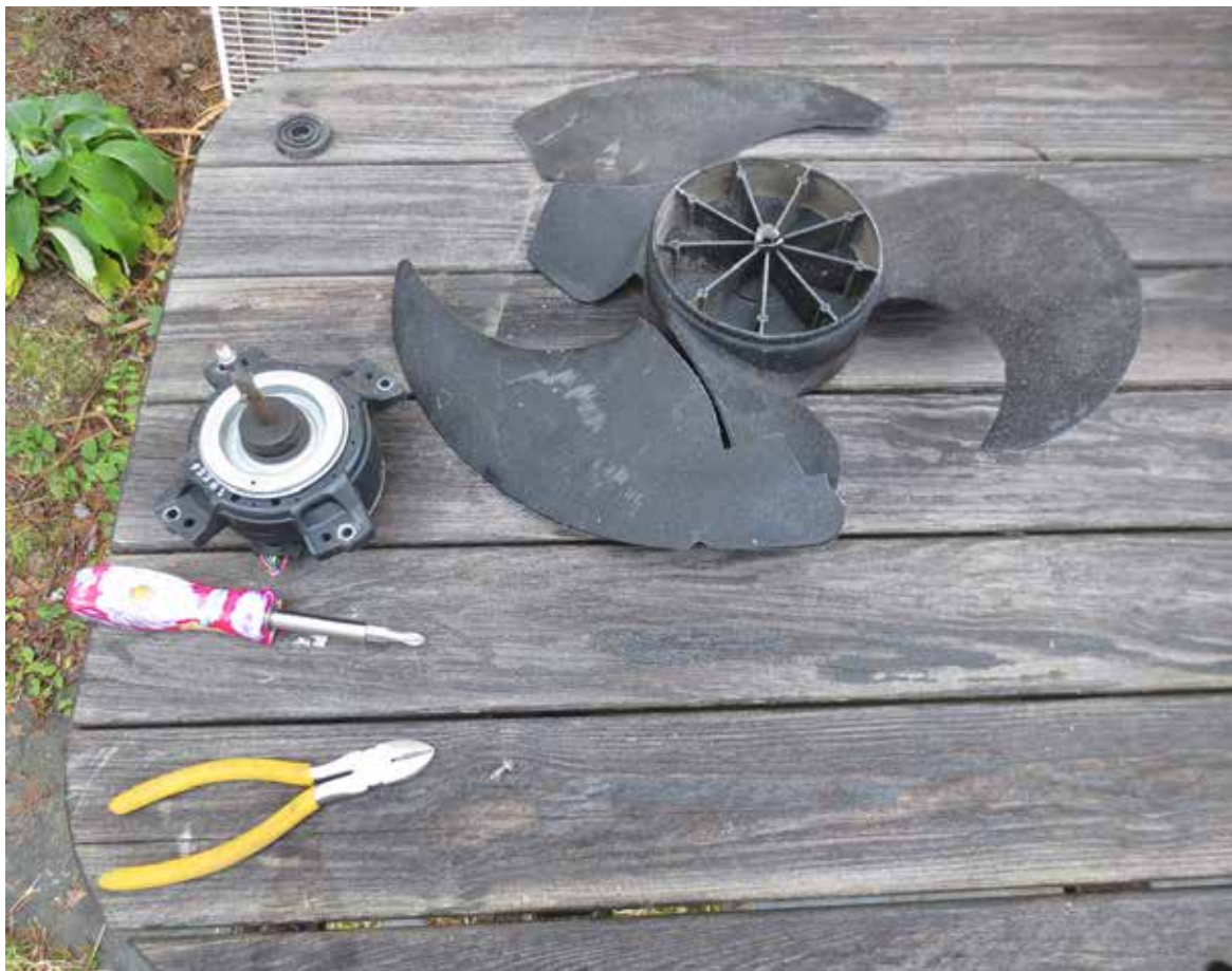
12-vuotiaan IVT-Ilmalämpöpumpun ulkoyksikön propelli meni päreiksi ja koko laite uusittiin
