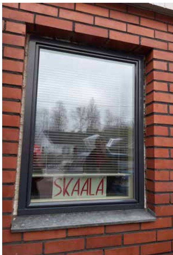
Skaalan ikkuna reunalistoja vailla valmiina.
