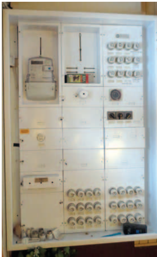
Sähköpääkeskus näyttää hyvältä, mutta uusimisen aika lähestyy.
