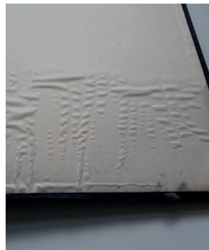
Tähän vaurioon en edes miettinyt kajoavani!
