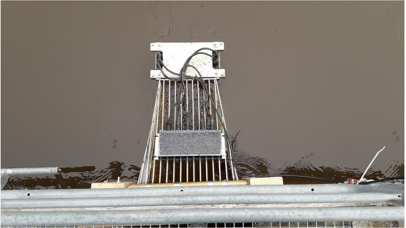
Kuva 1. VAKI-seurantalaitteisto asennettuna Pappilankosken kalatien yläpään (Kuva: Lauri Anttila).
