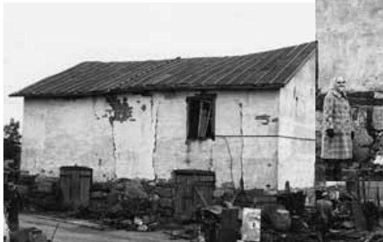
Someron Viinaprännin rakennus ennen hajottamistaan syksyllä vuonna 1966. Päädyn halkeamaa ihmettelemässä Lyydia ja Timo Tuominen. – Kuvat kirjoittajan.
