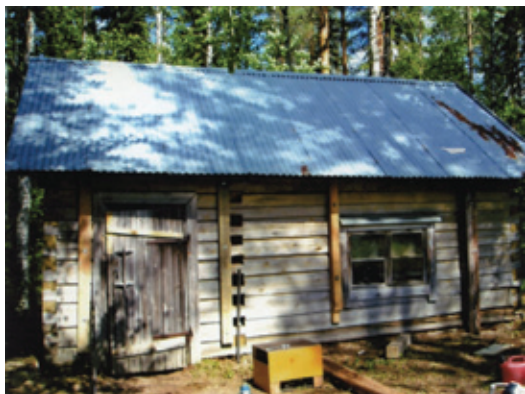
Entinen esikunnan sauna remontin alkaessa.
