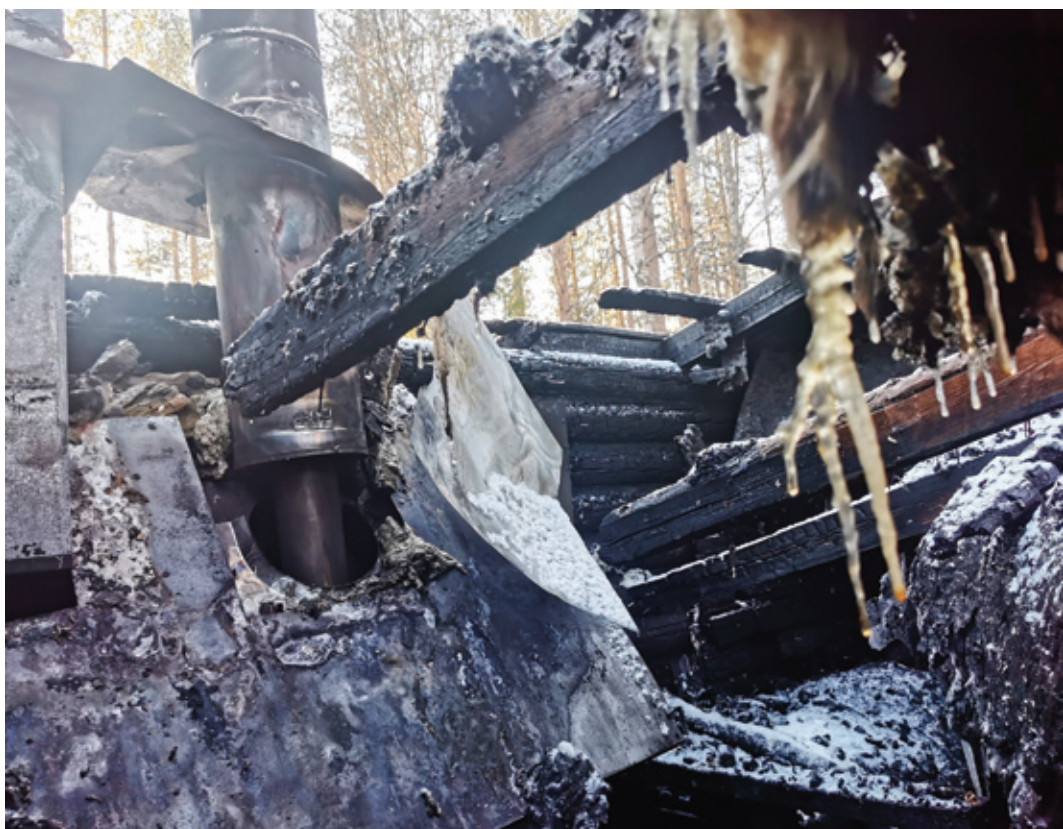
Kirjan jo mentyä painoon syttyi Ukonjoen sauna tuleen 28.10. -23 illalla. Päältäpäin vauriot näyttävät vähäisiltä, mutta sisältä tuho on täydellinen. Viiden vuosikymmenen löyly on lyöty.
