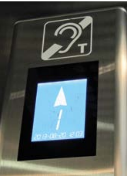
Hississä tarvittava induktio-silmukka.
