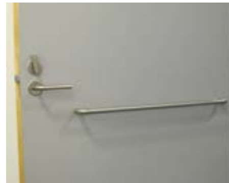
Vaakasuuntainen vedin esteettömän wc-tilan oven sisäpuolella.
