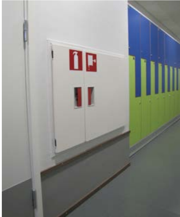
Kulkuväylille ei saa asentaa törmäysvaaraa aiheuttavia varusteita.
