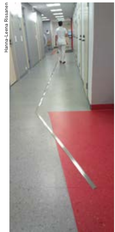
Opaste lääkärikeskuksen lattiassa. RT 91-11282 Kiinteistön opasteet.
