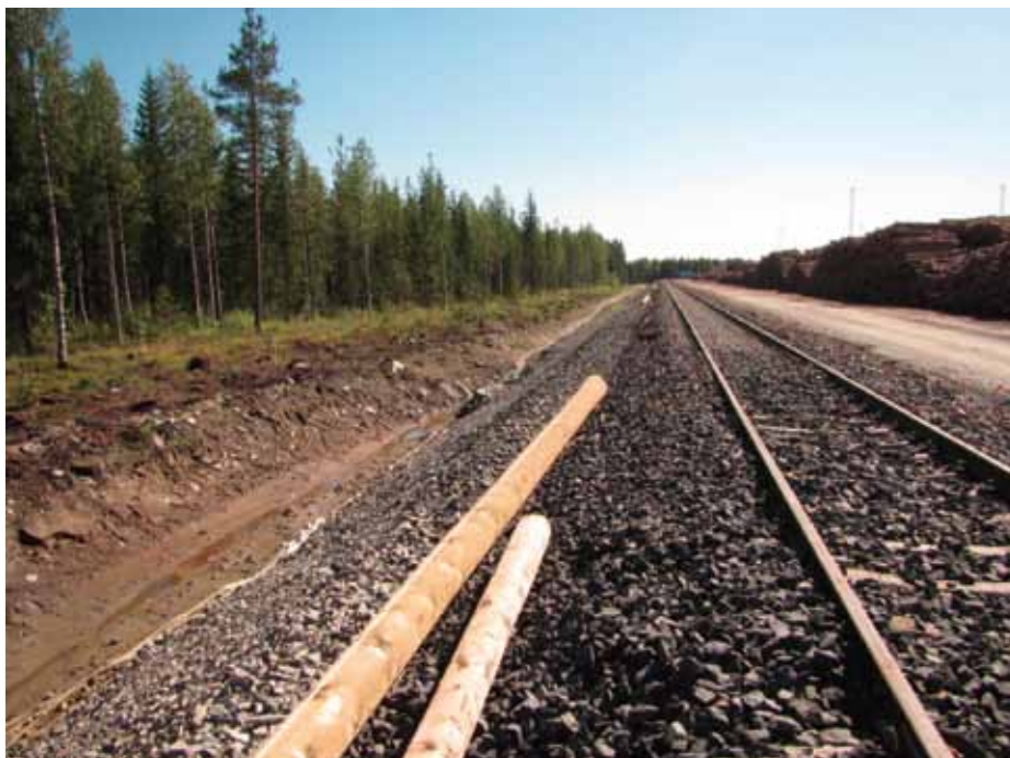
Kuva 4: Valaisinpylväät odottavat asennusta
