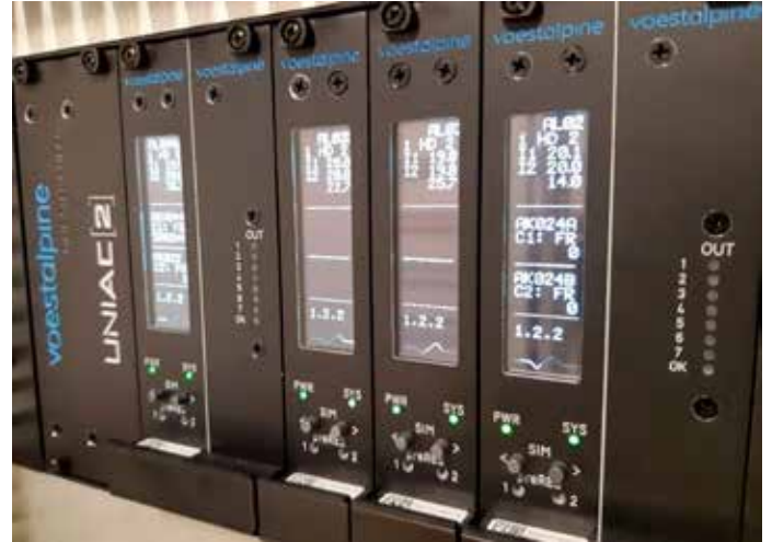
Kuva 5. Voestalpine akselinlaskentajärjestelmä hoitaa osuuk-sien vapaana olon -valvonnan
