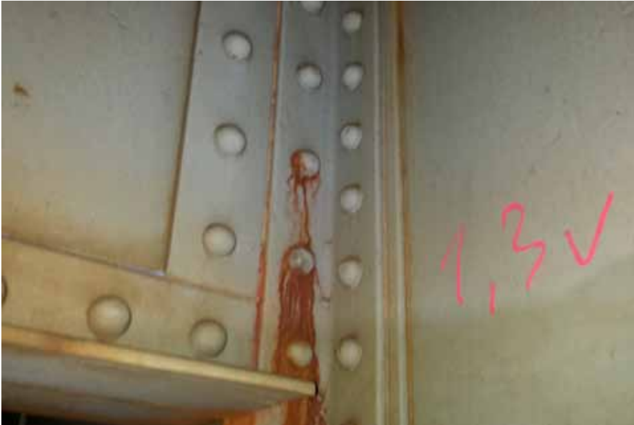
Kuva 4. Teräsiitosten itkeviä liitoksia ennen korjausta.
