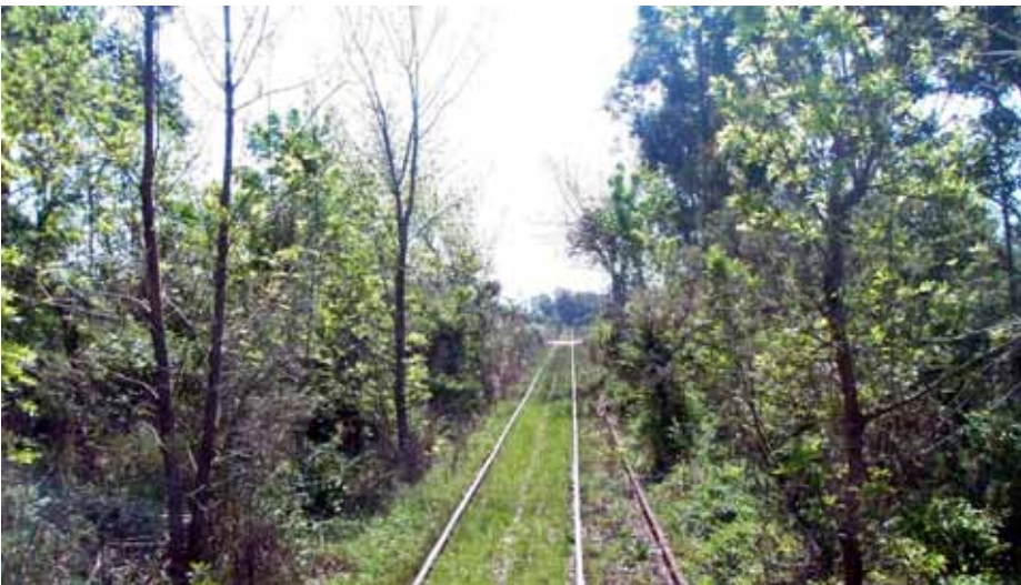
Kuva 8. Tämän rataosan kunnossapito on ollut melko vähäistä.
