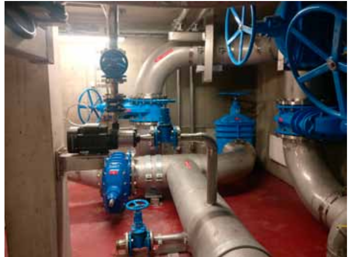
Pumppaamon sisäpuolisia putkituksia. Kuvassa näkyy myös paineen ylläpitopumppu 15.3.2019.
