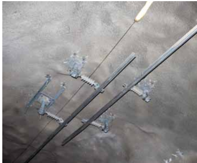
Kiintoajojohtohdon erotuskenttä. Kuva: Esa Ojanperä
