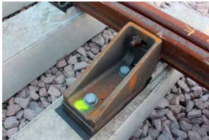
Vastakiskopukin järeät läpivetopultit, jotka ottavat entisiä rai-deruuveja paremmin vastaan poikittaisvoimia.
