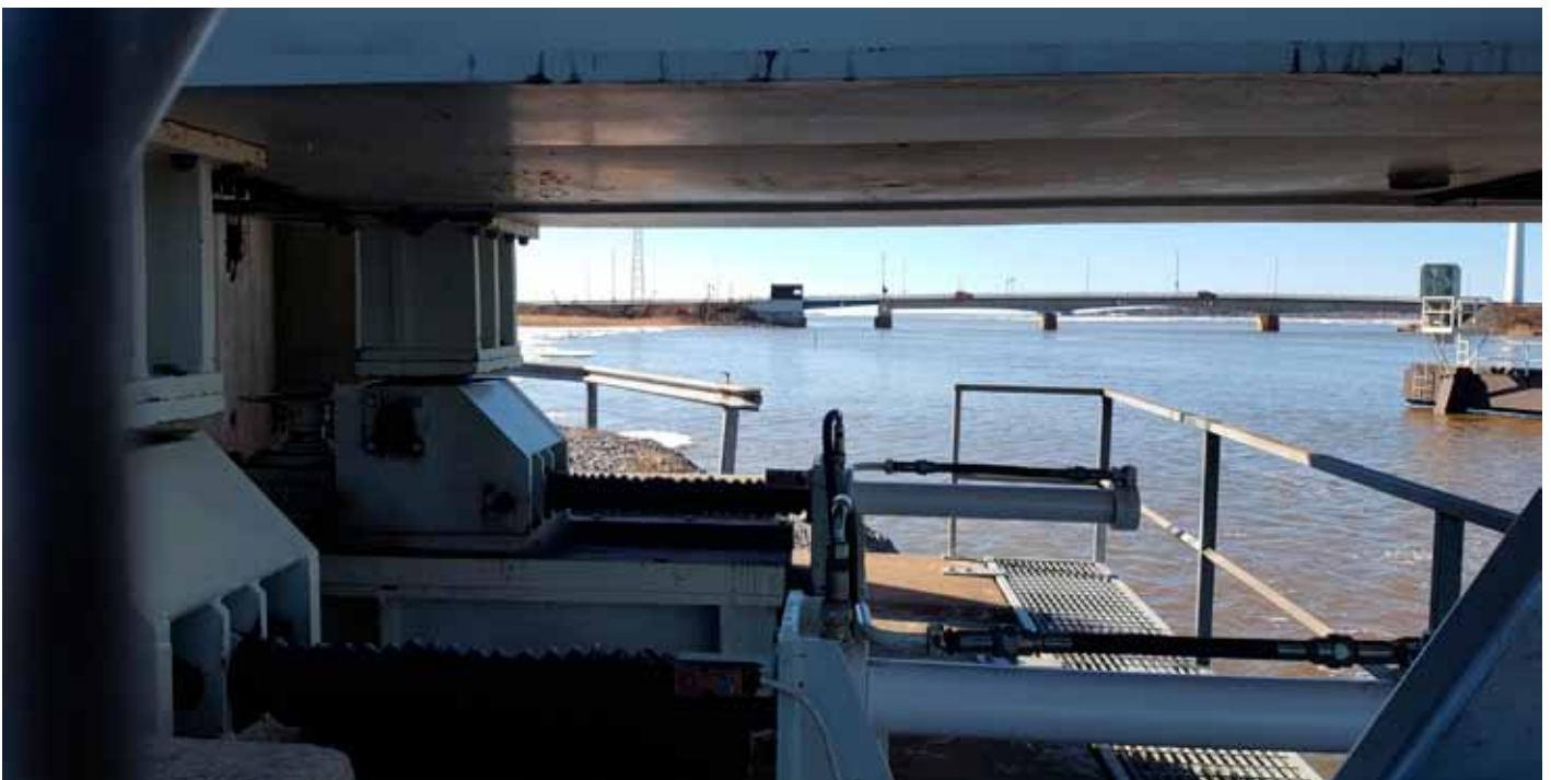
Kuva 4. Sillan laakereita ja kääntölaitteita maatuella.
