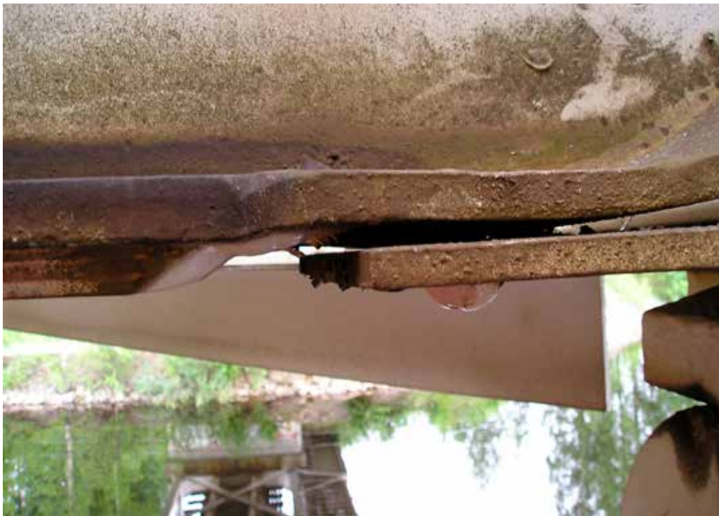
Kuva 5. Sillassa on havaintoja irronneista niiteistä ja levyistä, joita on korjattu sitä mukaan, kun niitä on havaittu.
