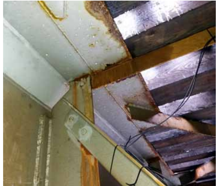
Kuva 3. Katkenneita ja korjattuja liitoksia.
