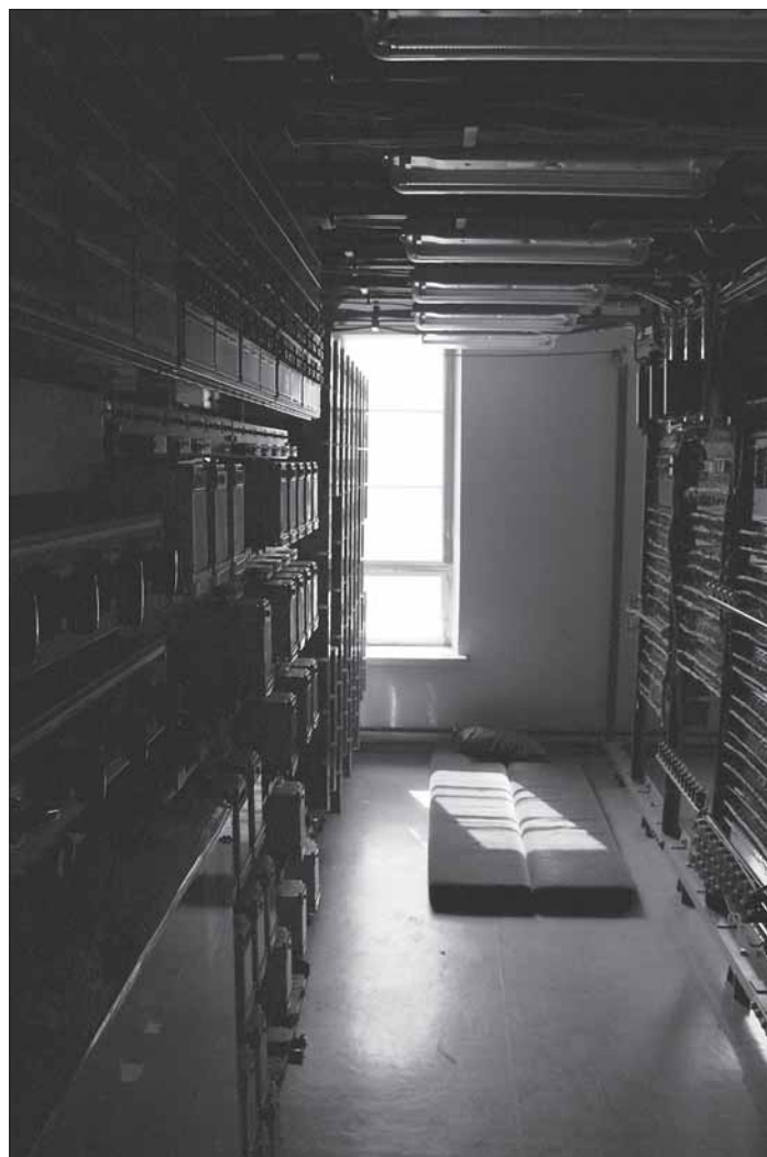
Uneliaan releasetinlaitehuoneen tunnelmaa.
