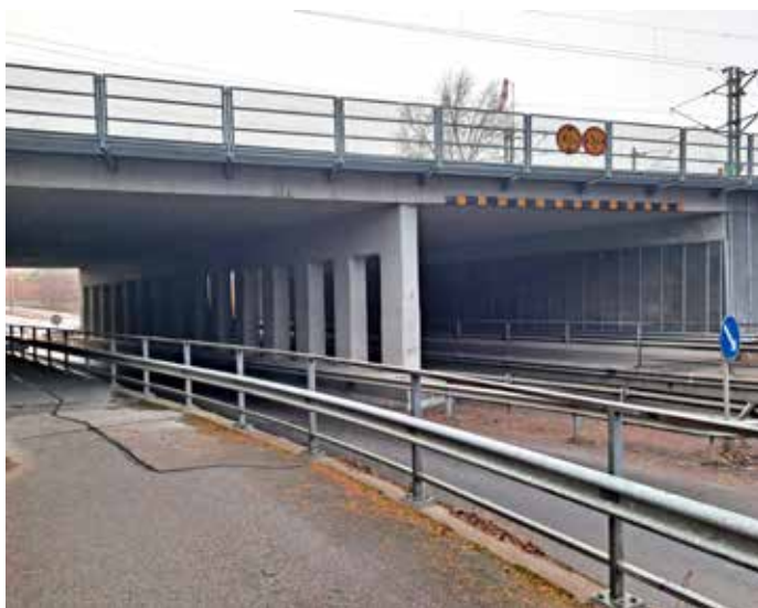
Kuva 2. Vanha silta oli kantavuuspuutteiden lisäksi pimeä ja ahdas.
