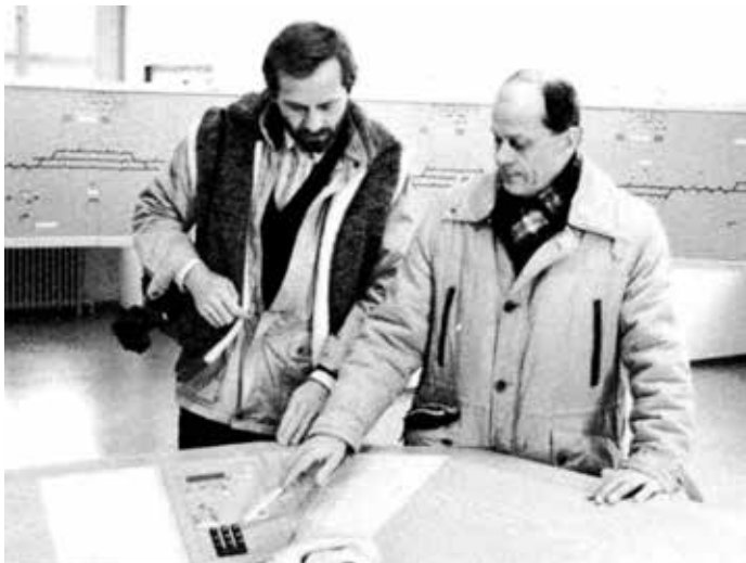
Kuva 2. ZUS-kauko-ohjauksen alkuperäinen ohjausnäppäimistö ja ilmaisintaulu Oulun kauko-ohjauskeskuksessa vuonna 1986. Oulun sähköalueen päällikkö Arponen esittelee näppäimistöä toimittajalle. Kuvassa vasemmanpuolimmaisimpana näkyy Vihannin liikennepaikka. Kuva: Timo Pappinen.
