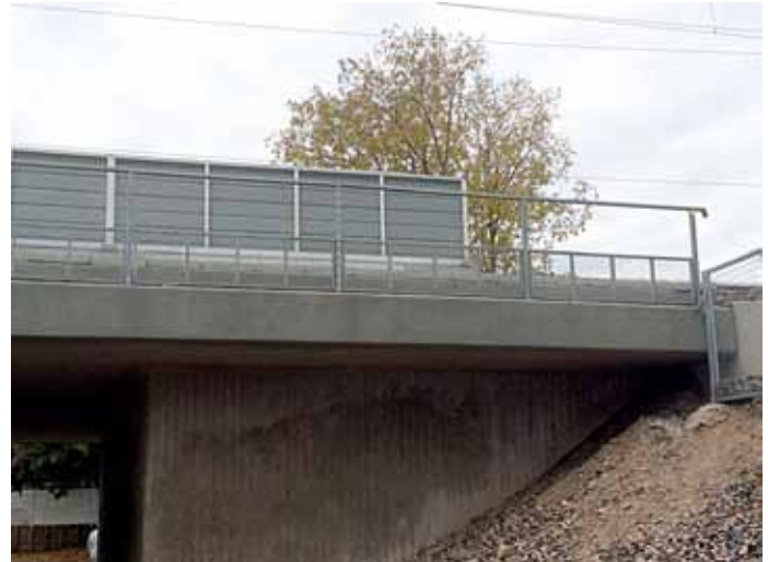
Kuva 3: Meluaitaa siltarakenteessa (Kari Häyrinen)
