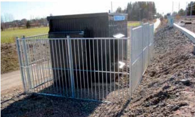
Kuva 3. Järjestelmän laitetila asennettuna aitauksineen vaihteiden läheisyyteen.
