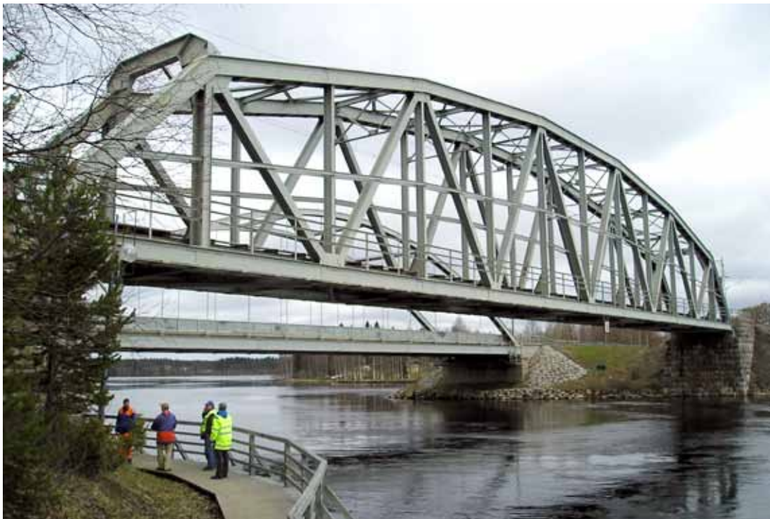
Paltamossa olevan Kiehimänjoen ratasillan käytäytymistä junien alla tutkittiin useaan kertaan vuosina 2011–2012
