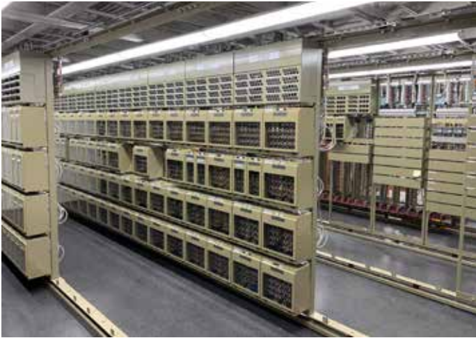
Kuva 3. Uusi asetinlaite rakennettuna valmiiksi odottamaan käyttöönottoa.
