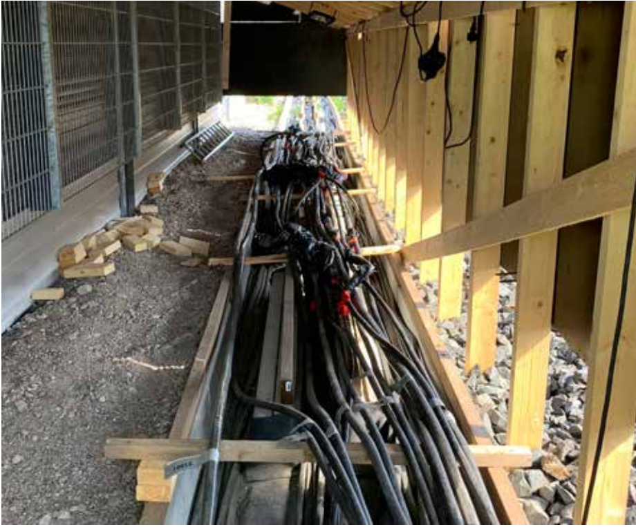
Kuva 8. Käyttöönoton aikainen runkokaapelien jatkostyömaa. Yhdessä runkokaapelissa saattoi olla usean eri työvaiheen turvalaite-elementeille meneviä kaapelsäikeitä, joten kaapeleiden suojaamiseen ja työjärjestykseen tuli kiinnittää suurta huomiota.
