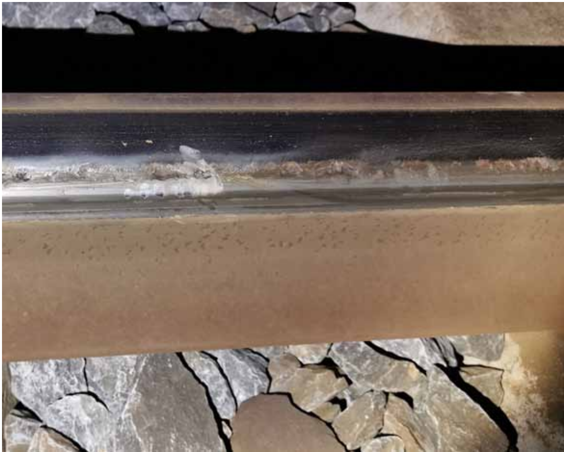
Kiskon pinnassa olevaa vierintäväsymistä..
