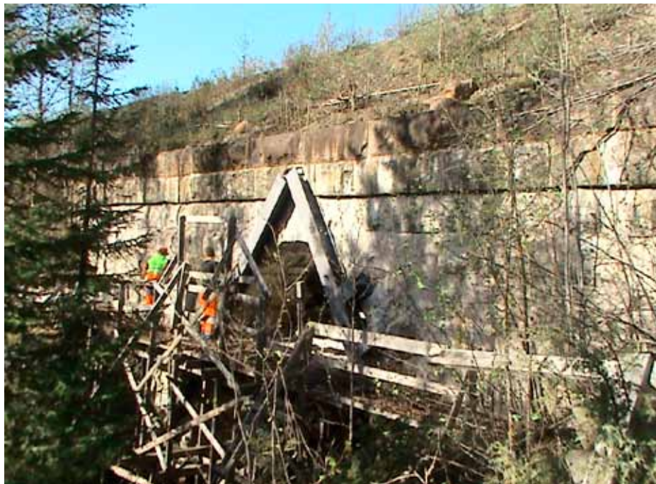
Kuva 7. Hiidenjoen ratasillassa Hyrynsalmella kaatuvaa reunarakennetta on tuettu teräsristikolla.
