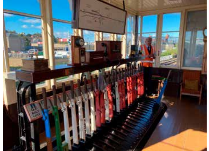
Kuva 8. Bo'ness-liikennepaikan 1800-luvulla valmistettu kankiasetinlaite operatiivisessa käytössä
