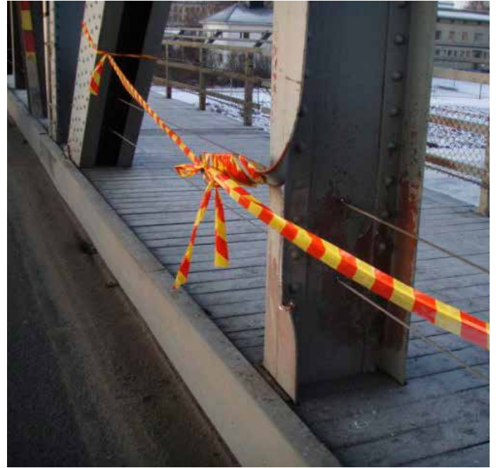
Kuva 5. Ajoneuvoliikenne on kolhinut siltarakenteita ahtaalla alakannella.
