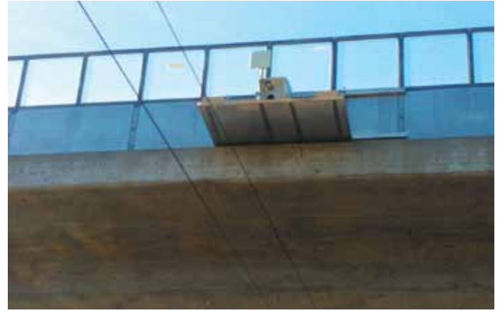
APMS -järjestelmä liikkuvan kaluston virroitimen kunnonvalvontaan
