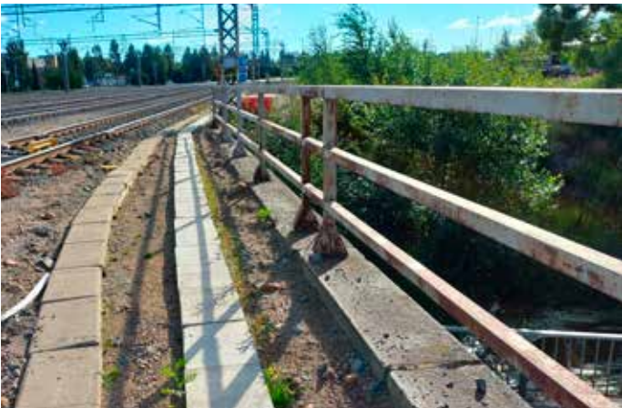
Kuva 3. Vanhat kulmateräskakaiteet Kokkolanjoen ratasillassa.
