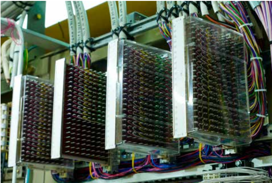
Esimerkillisesti toteutettua DrS- systemikaapelointia
