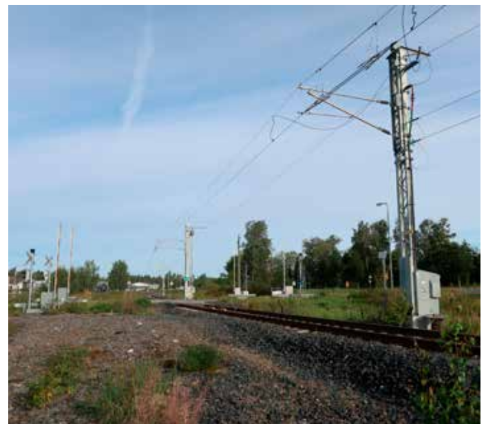
Kuva 2. Ajojohtimen nostolaitteisto kilometrillä 325+030 Tikkulan tasoristeyksessä Pori–Mäntyluoto-rataosalla. Etäkäyttöisellä ajojohtimen nostolaitteistolla jännitteetön ajojohdinta voidaan nostaa enimmillään 6,0 m korkeuteen. Kuva kirjoittajan. Pori, 18.8.2023.
