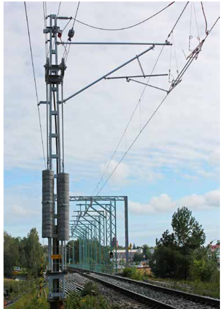
Kuva 5. Tammisaaren seisakkeen eteläpuolella Raaseporissa sijaitsevalle Pohjan kääntösillalle rakennettiin Karjaa–Hankorataosan sähköistämisen yhteydessä ajojohdinrakenteet. Siltaa käännettäessä jännitteetön kiintoajojohdin kääntyy kääntyvän osan mukana. Kuva kirjoittajan. Raasepori, 26.8.2023.
