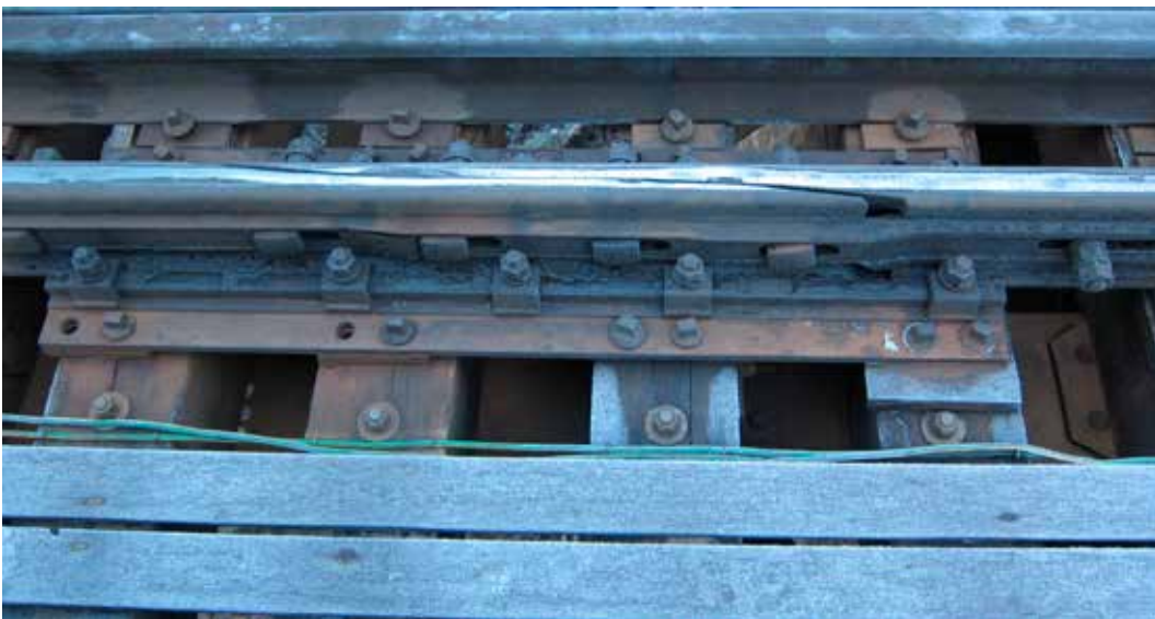
Kuva 1. 54-kiskopainon kiskonliikuntalaitte. Kiskonliikuntalaitte on poistettu ja tehty liukuva kiskonkiinnitys. Simojoen ratasilta. Kuva Raimo Hämäläinen
