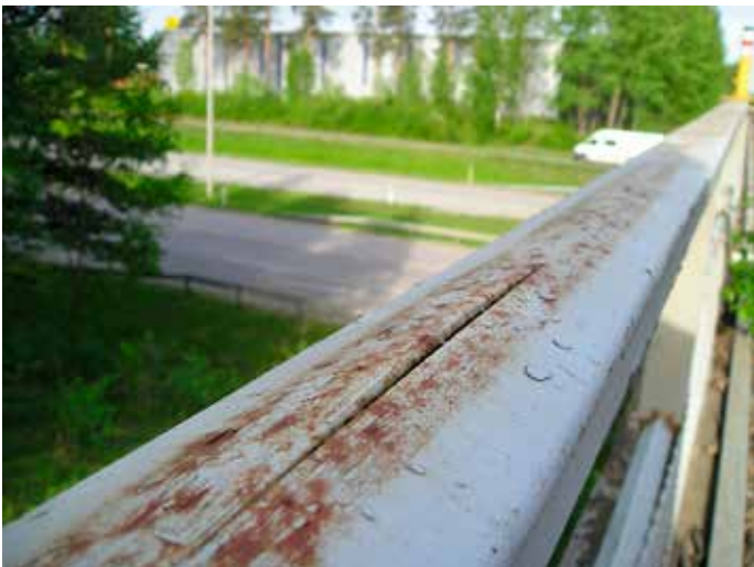
Kuva 6. Kondenssiveden kertymä teräsputkessa halkaisee johdetta Käpykankaan alikulkusillassa.
