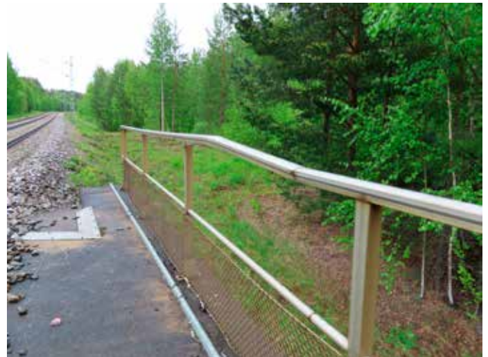
Kuva 7. Alumiinikaiteet kestävät heikosti iskuja, esimerkkinä Metsolahden alikulkusillalla.
