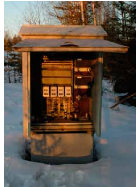
3. Tuomiblockin välisuojauspaikan ohjauslaitteet sijoitettuna lentokonekaappiin. Kuva: Tero Sorsimo
