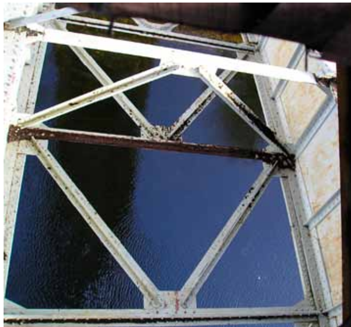
Kuva 4. Sillan vaakasiteisiin on kertynyt paljon likaa.
