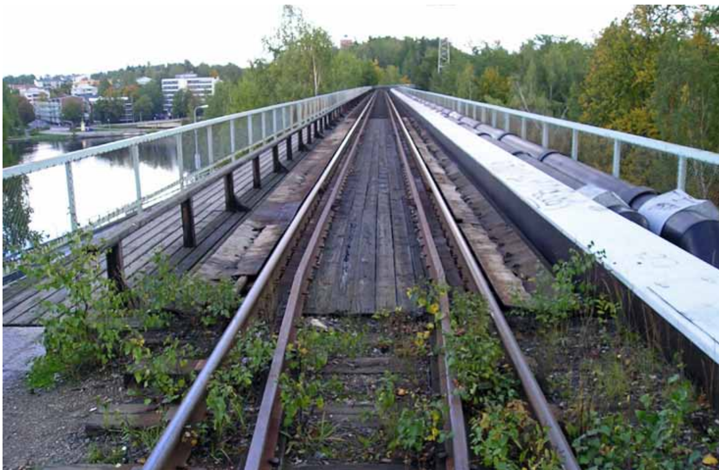
Kuva 5. Sillan päällä on jalankulku-uloke ja putkistoa. Alla kulkevan liikenteen suojaksi raiteiden väliin on asennettu levyjä, jotka päässeet jo huonoon kuntoon.
