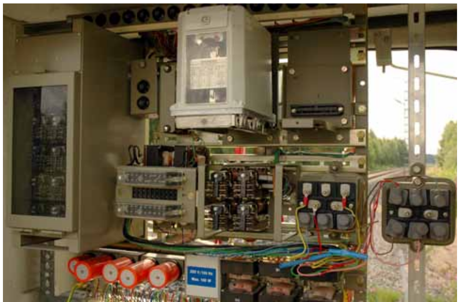
5. Selbstblock VR -järjestelmän radan varren ohjauslaitteistoa Pohjanmaalla kuvattuna. Kuva: Tero Sorsimo
