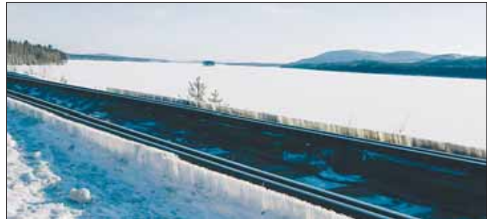
Harjaksilla suojattu vaihde ta kunnossapitoa.
