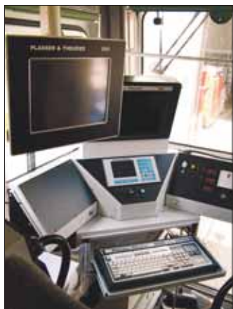
Kone-esimiehen toimintaympäristö koneella työskenneltäessä. Ohjaustietokoneen- ja työjäljenpiirturin laitteet.
