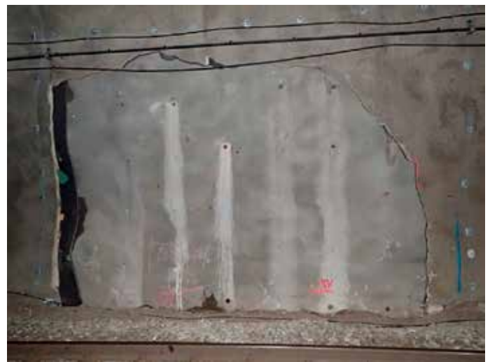
Kuva 2. Märjännäen tunnelin lämpöeristeen päällä olevan ruiskubetonin vaurio.
