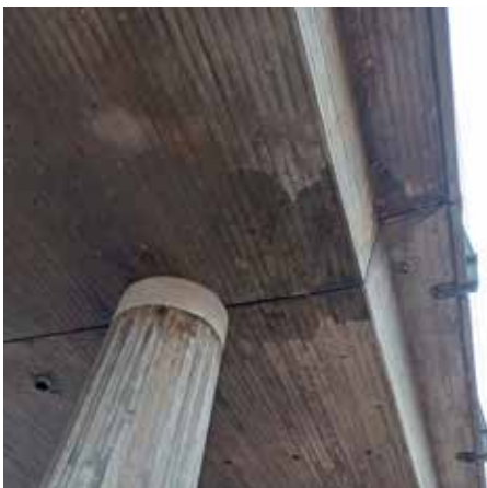
Kuva 5. Sillan kansi ja liikuntasauvat vuotavat pahoin.
