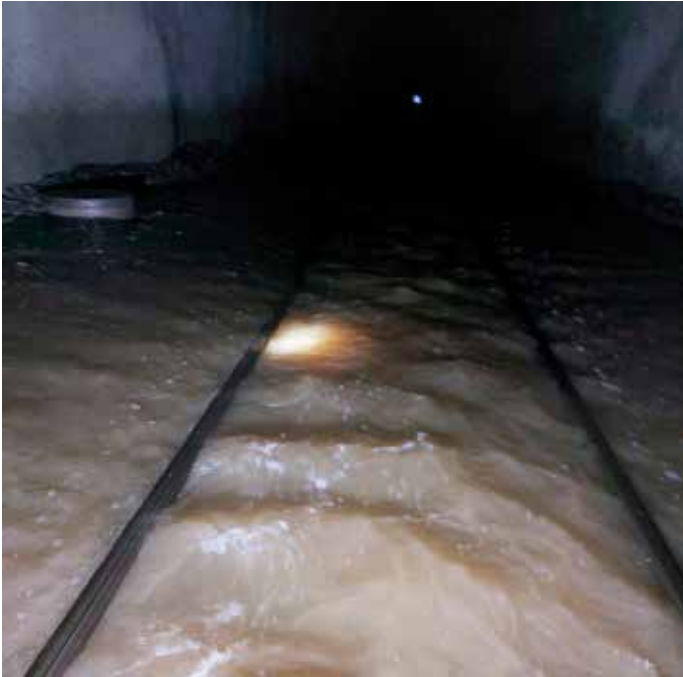
Kuva 3. Märjämäen tunnelin tulviva raide.
