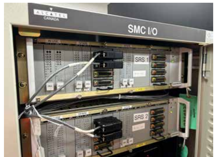
Kuva 7. Maailman ensimmäisen CBTC-rataosan, Toronto metrolinja 1 laitteistoa (1985 –2023)
