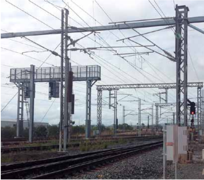
Paikallisia sähköratarakenteita. Huomaa mm. tuttu 2-osainen kiristyslaitteisto.
