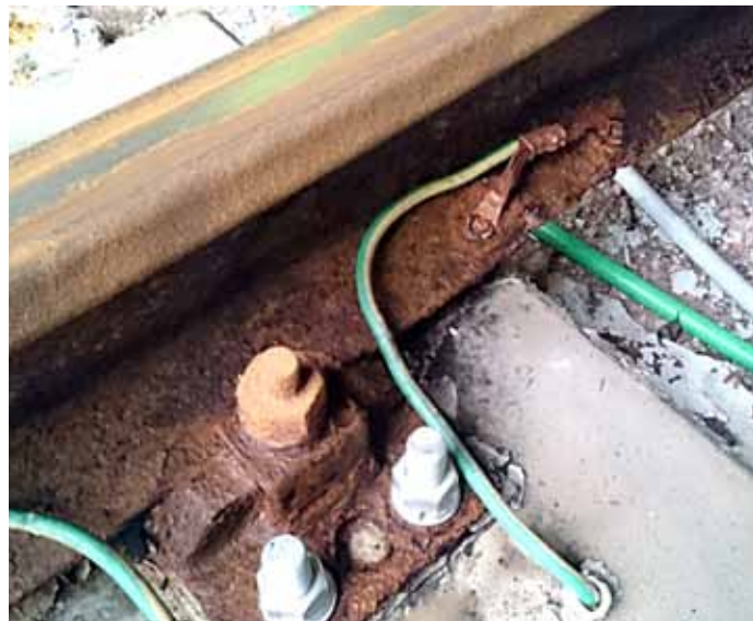
Kuva 6. Happokaaren kohdalla voimakkaasti korrosoitunut kisko ja aluslevy.
