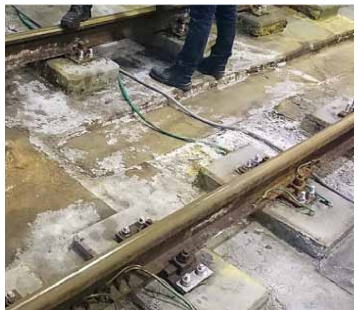
Kuva 4. Ilmalan kaukojunien pesuhallin syöpynyttä betonia, pinnoitetta ja kiskoa.
