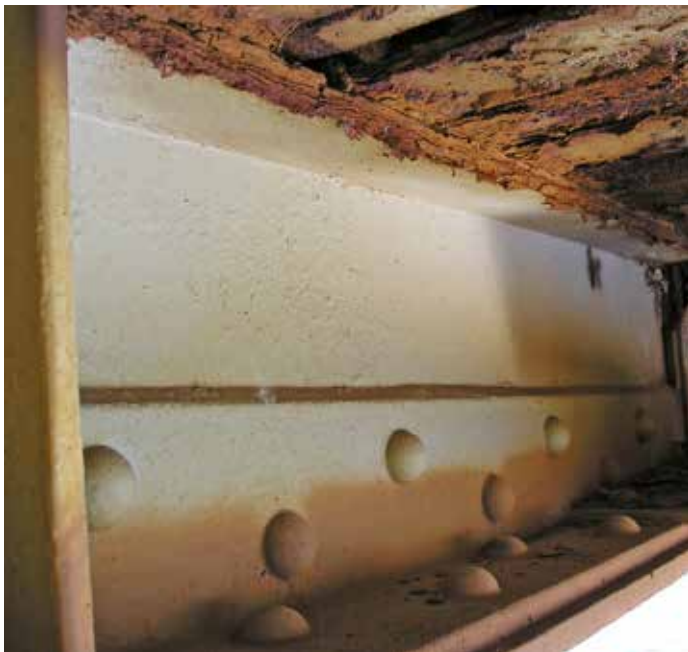
Kuva 4. Osa sillasta oli päässyt jo huonoon kuntoon.
