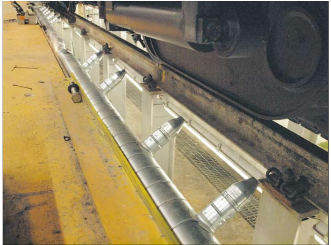
Kuvassa putket, joita myöten lämmin ilma johdetaan alimmissa kuvassa näkyvään kanavistoon.
