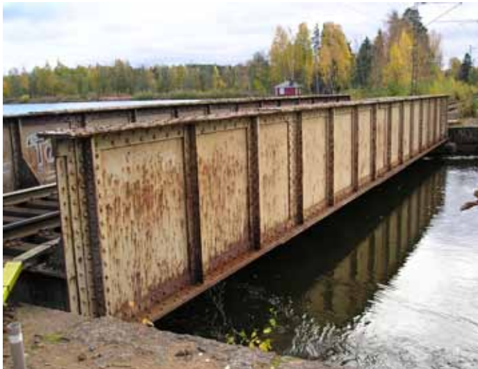
Kuva 2. Vanha vuonna 1927 uusittu silta oli päästetty huonoon kuntoon ennen kuin se uusittiin 2012.
